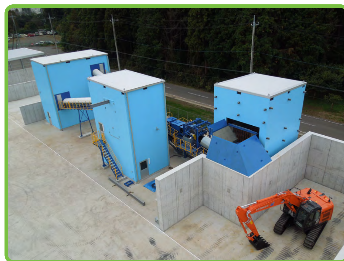
がれき類処理設備 全景
