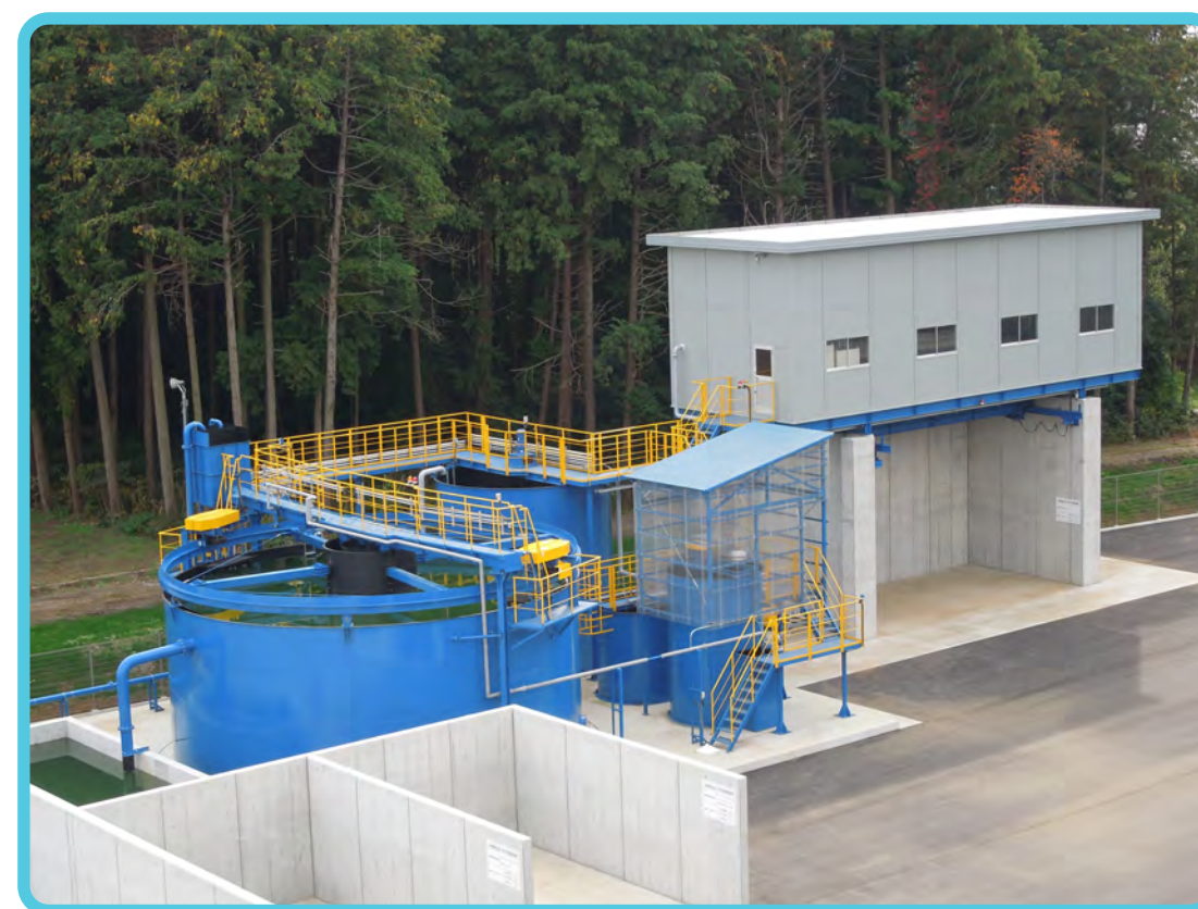
脱水設備 全景
